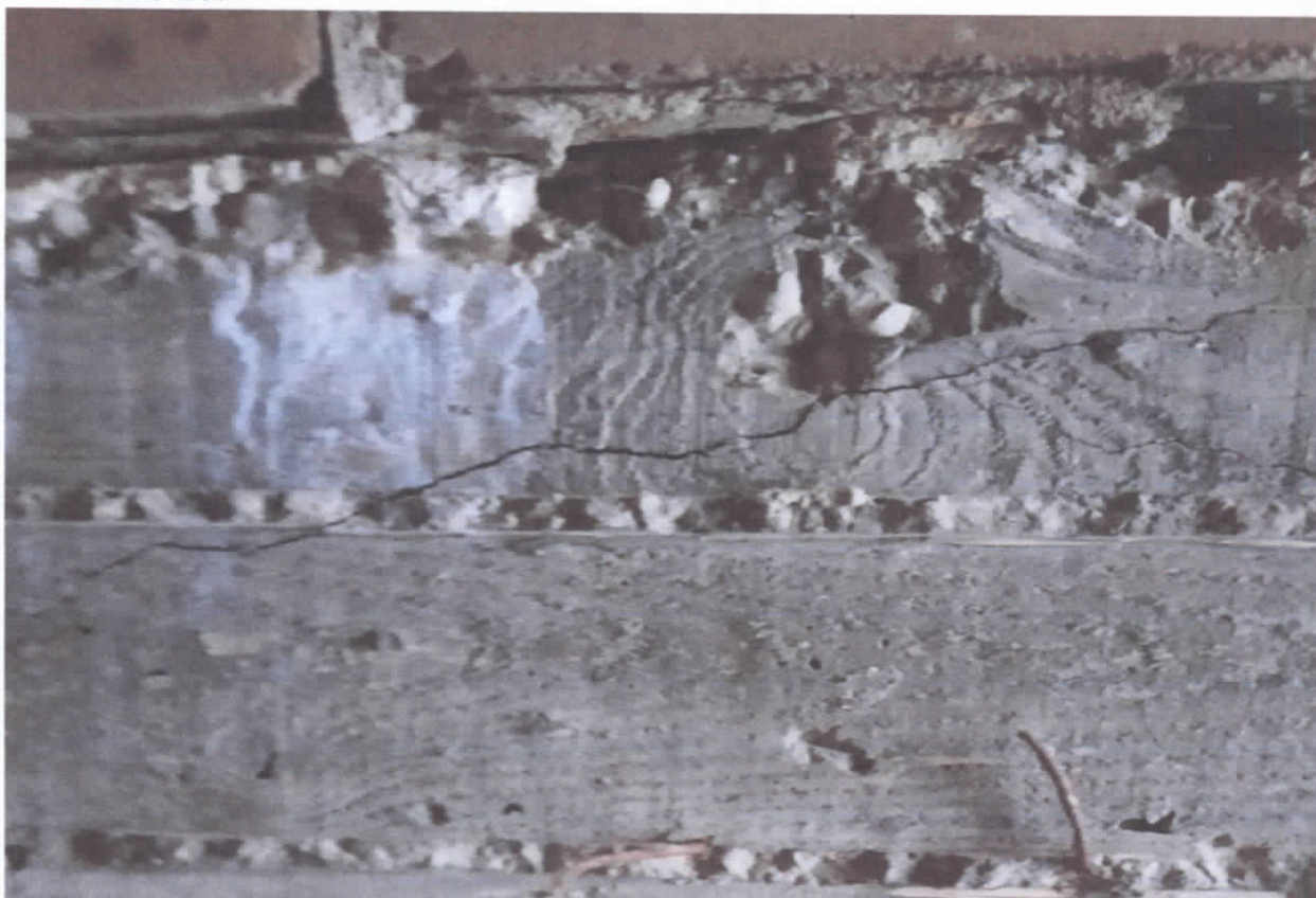
Трещины горизонтального и косого развития с раскрытием 0.9мм. Фото 20.
