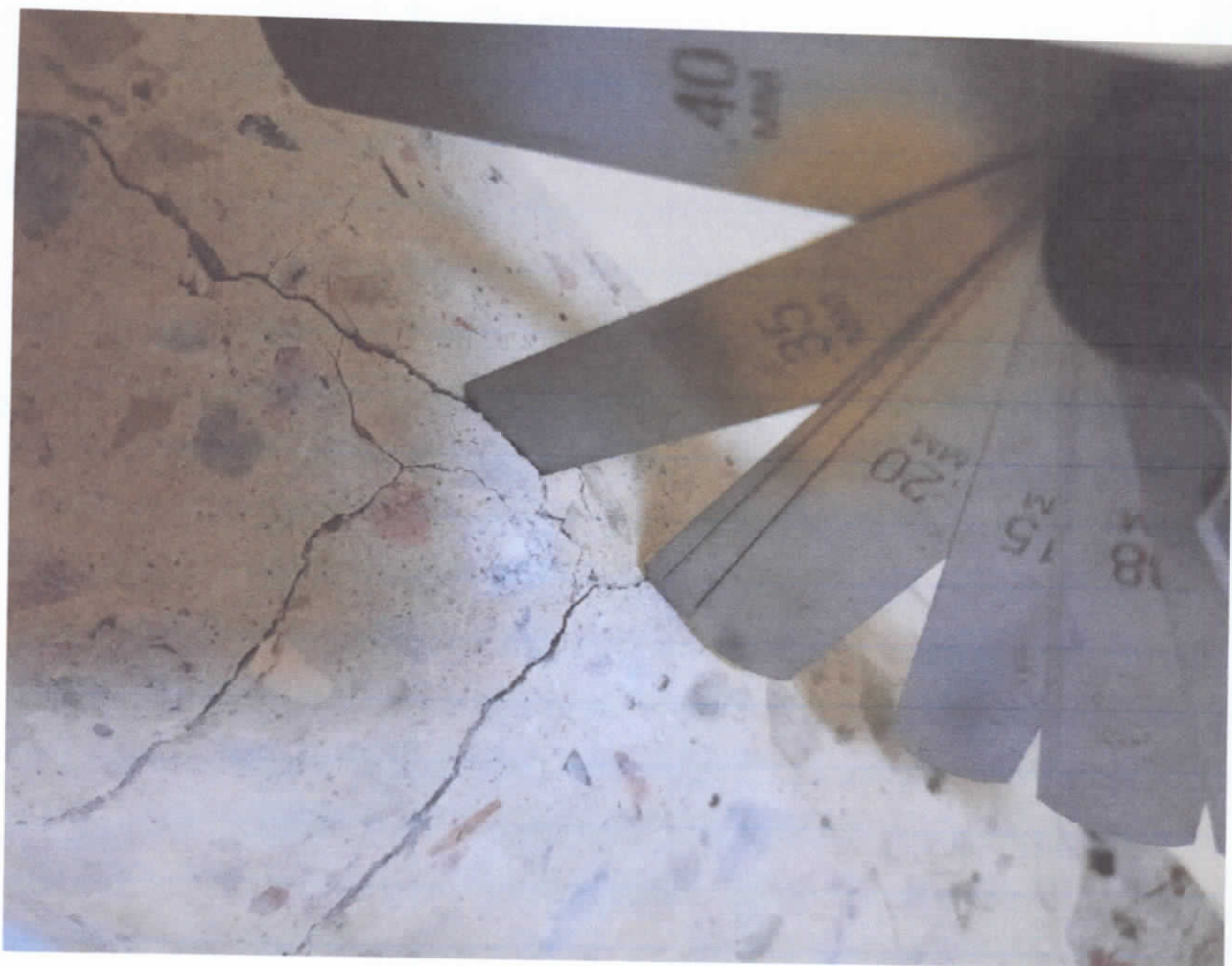
На разломах виден неоднородный состав бетона, пористость и трещины.
